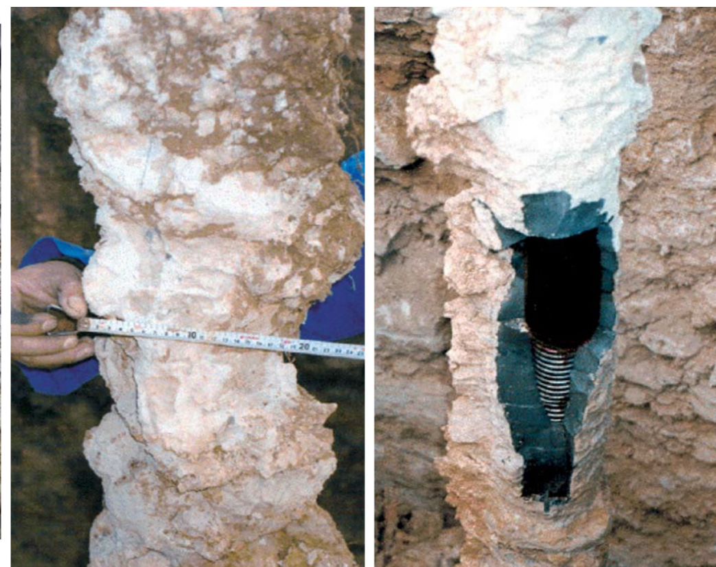
Photo n° 13 : bulbes de boulons d'ancrage déterrés (photos Ischebeck).
