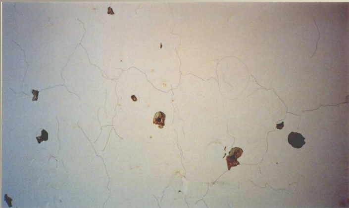
Fig. 5 - Faïençage du sous-plafond d'un escalier du bâtiment 1
